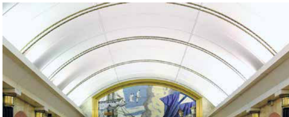
Рис. 10. Композитные водоотводные зонты на ст. «Адмиралтейская»
