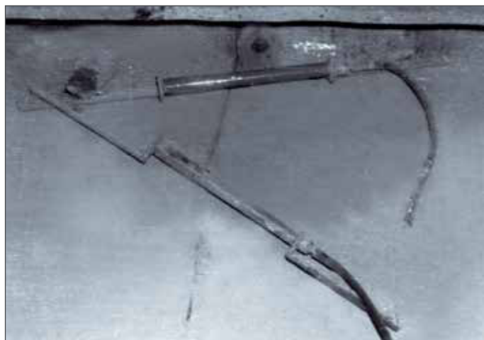
Рис. 4. Деформометры ПЛДС-400 на одиночной трещине в блоке
